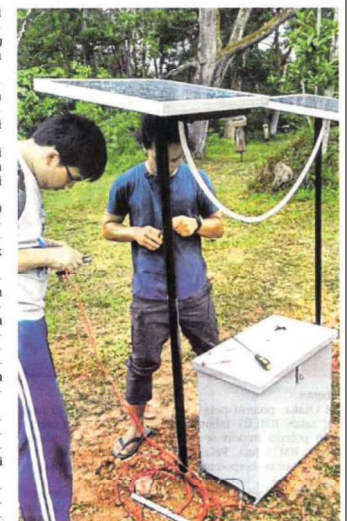
PENUNTUT membangun Tenaga Solar PV bagi sistem fertigasi di UTM, Skudai.
