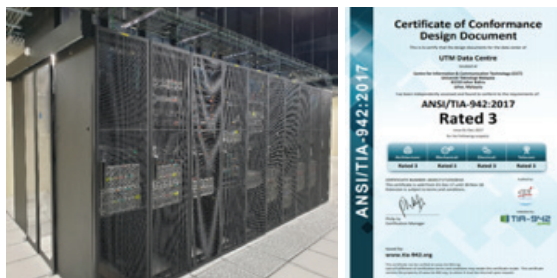
Ruang Pelayan Komputer di Pusat Data UTM
